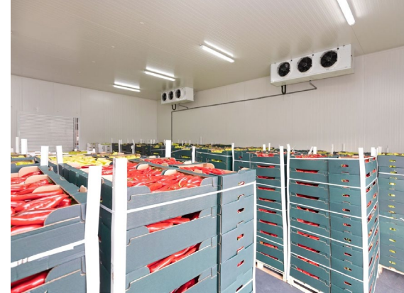
Almacenamiento en frío
