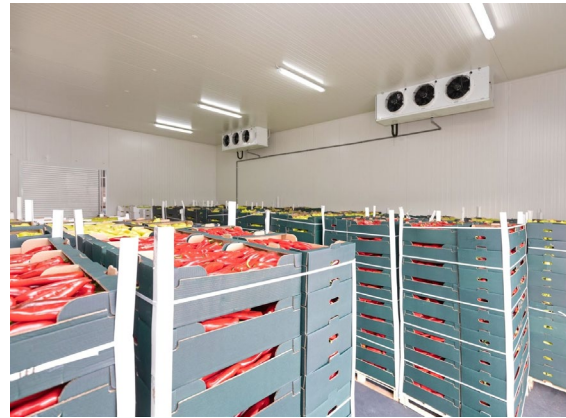
冷藏存储与仓储
